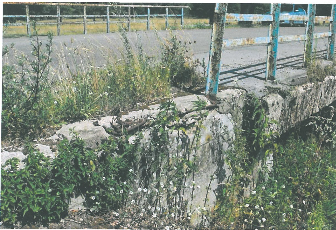
Fot. 7. Widok od skrzydło południowe przyczółka zachodniego. Widoczne ubytki betonu, korozja stali zbrojeniowej oraz intensywna wegetacja roślinności.
