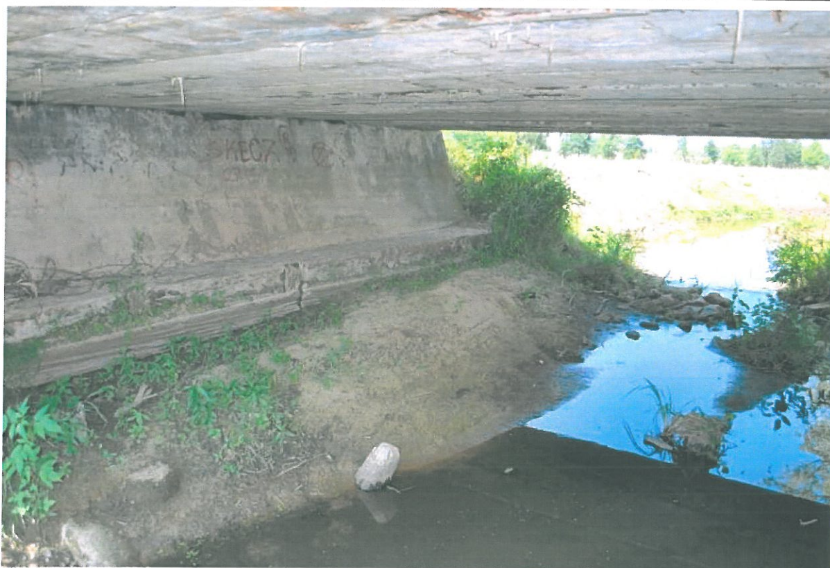
Fot. 20. Widok na przestrzeń podmostową. Widoczna wegetacja roślinności, ubytki oraz zanieczyszczenia terenu.
