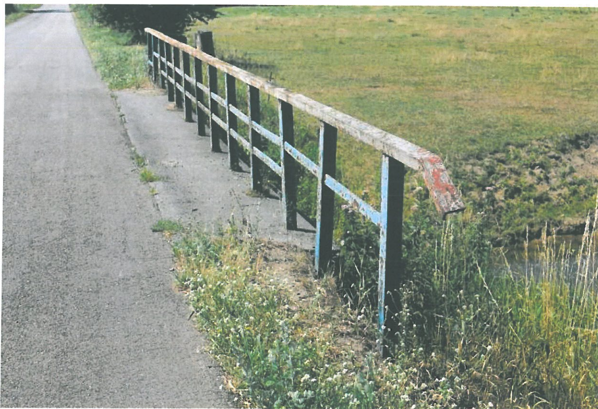
Fot. 9. Widok na balustradę północną od strony wschodniej. Widoczna korozja stali oraz ubytki przeciągów stalowych balustrady. Intensywna wegetacja roślinności przy skrzydle przyczółka wschodniego.
