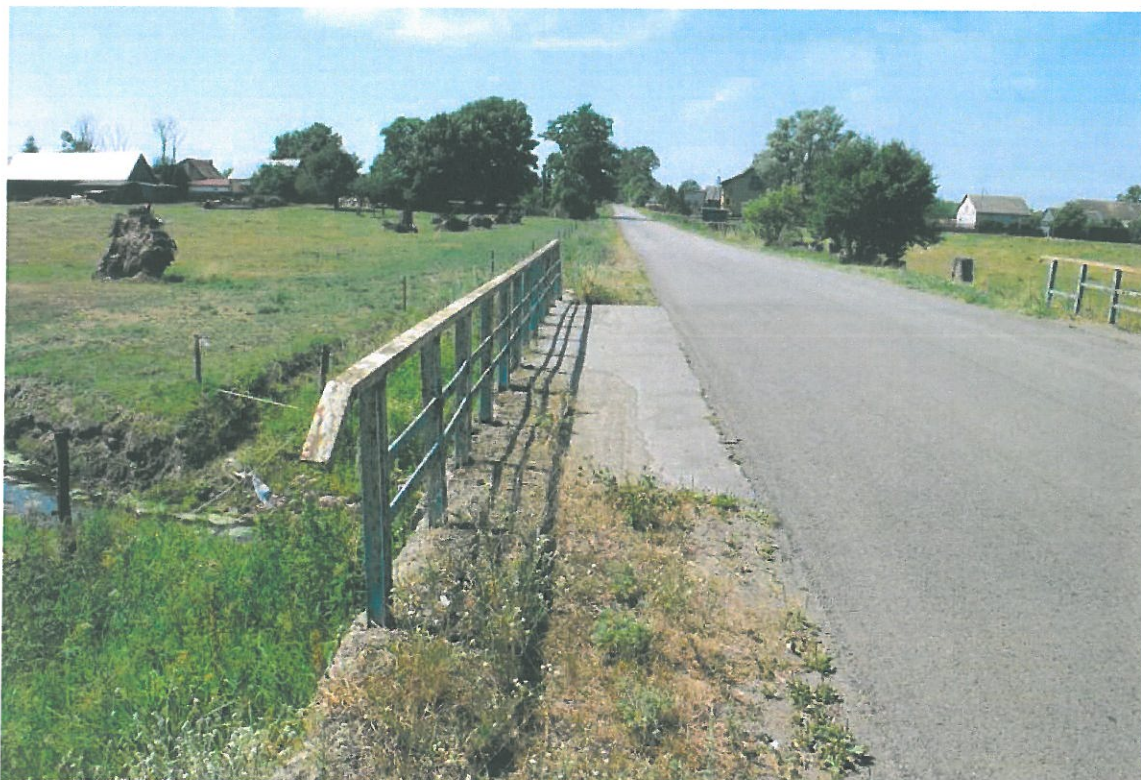
Fot. 5. Widok na chodnik południowy od strony wschodniej. Widoczna intensywna wegetacja roślinności świadcząca o braku systematycznych prac utrzymaniowych.
