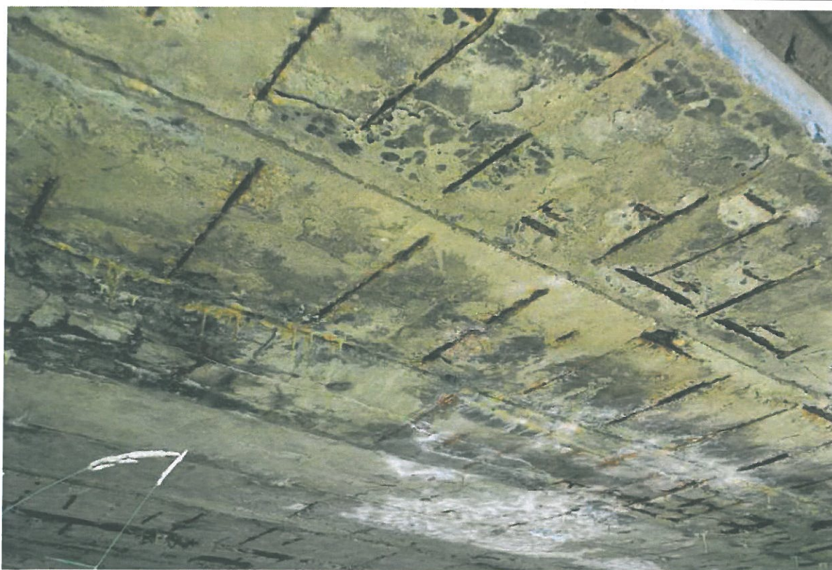
Fot. 14. Widok spod konstrukcji nośnej obiektu. Widoczne korozja i ubytki betonu, korozja stali zbrojeniowej oraz zacieki i osady, które wskazują na całkowity brak skuteczności izolacji pomostu.
