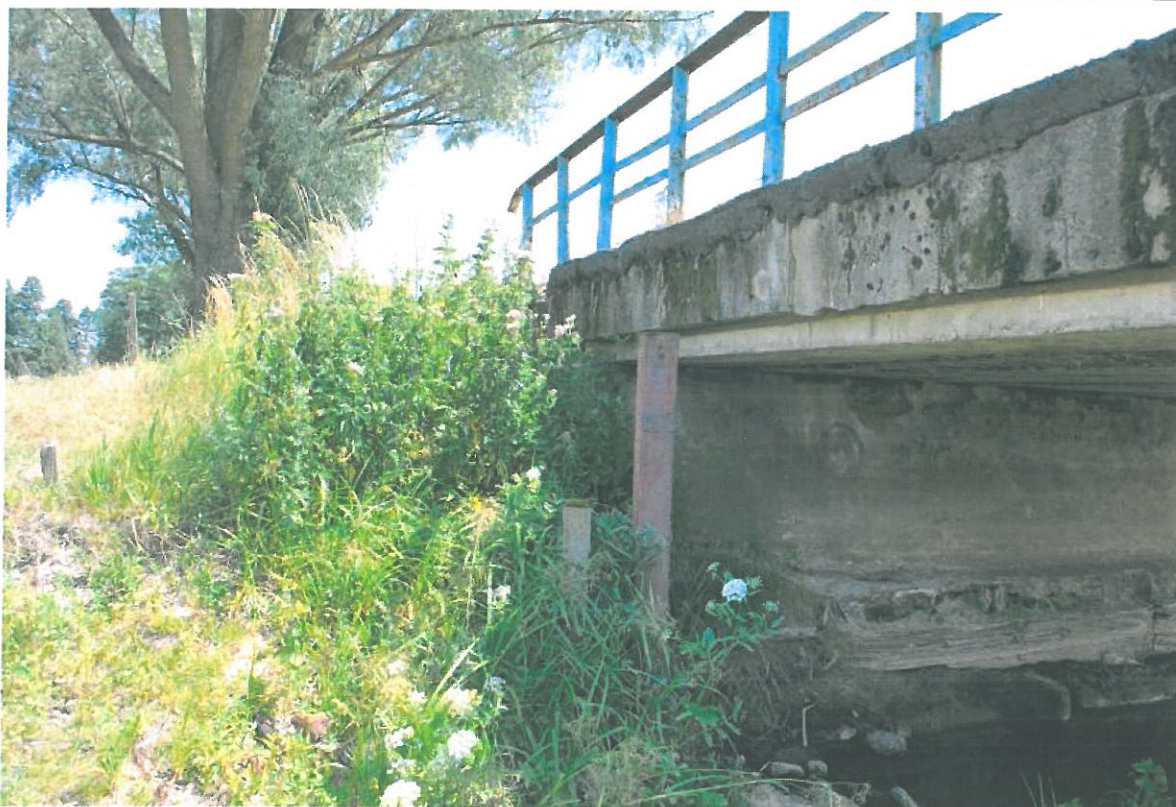
Fot. 12. Widok na skarpe przyczółka wschodniego po stronie północnej. Widoczna intensywna wegetacja świadcząca o braku systematycznych prac utrzymaniowych.
