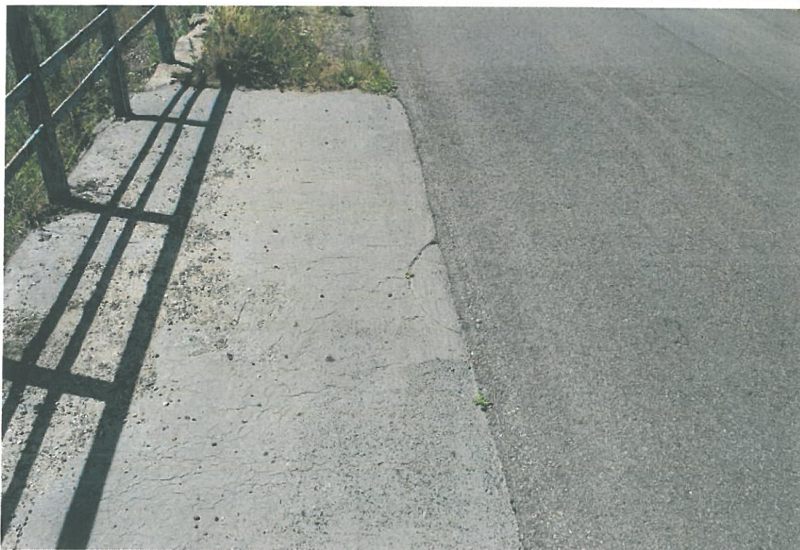
Fot. 6. Widok na chodnik południowy po stronie zachodniej. Widoczne rysy asfaltu, zanieczyszczenia nawierzchni chodnika oraz intensywna wegetacji roślinności przy skrzydle przyczółka.
