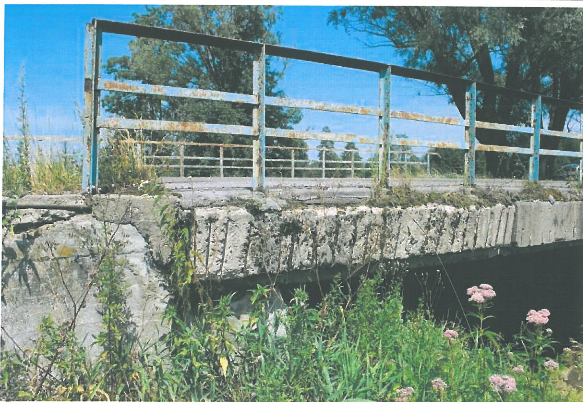
Fot. 8. Widok na gzyms po stronie południowej przy przyczółku zachodnim. Widoczna korozja i ubytki betonu, korozja stali zbrojeniowej oraz wegetacja roślinności na gzymsie. Brak odcinka pochwytu na skrajnym segmencie balustrady.
