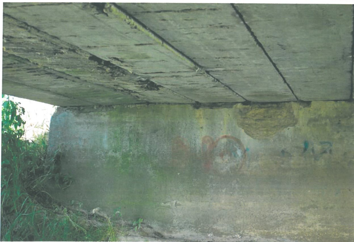
Fot. 19. Widok ścianę czołową przyczółka wschodniego. Widoczne ubytki i zanieczyszczenia betonu.
