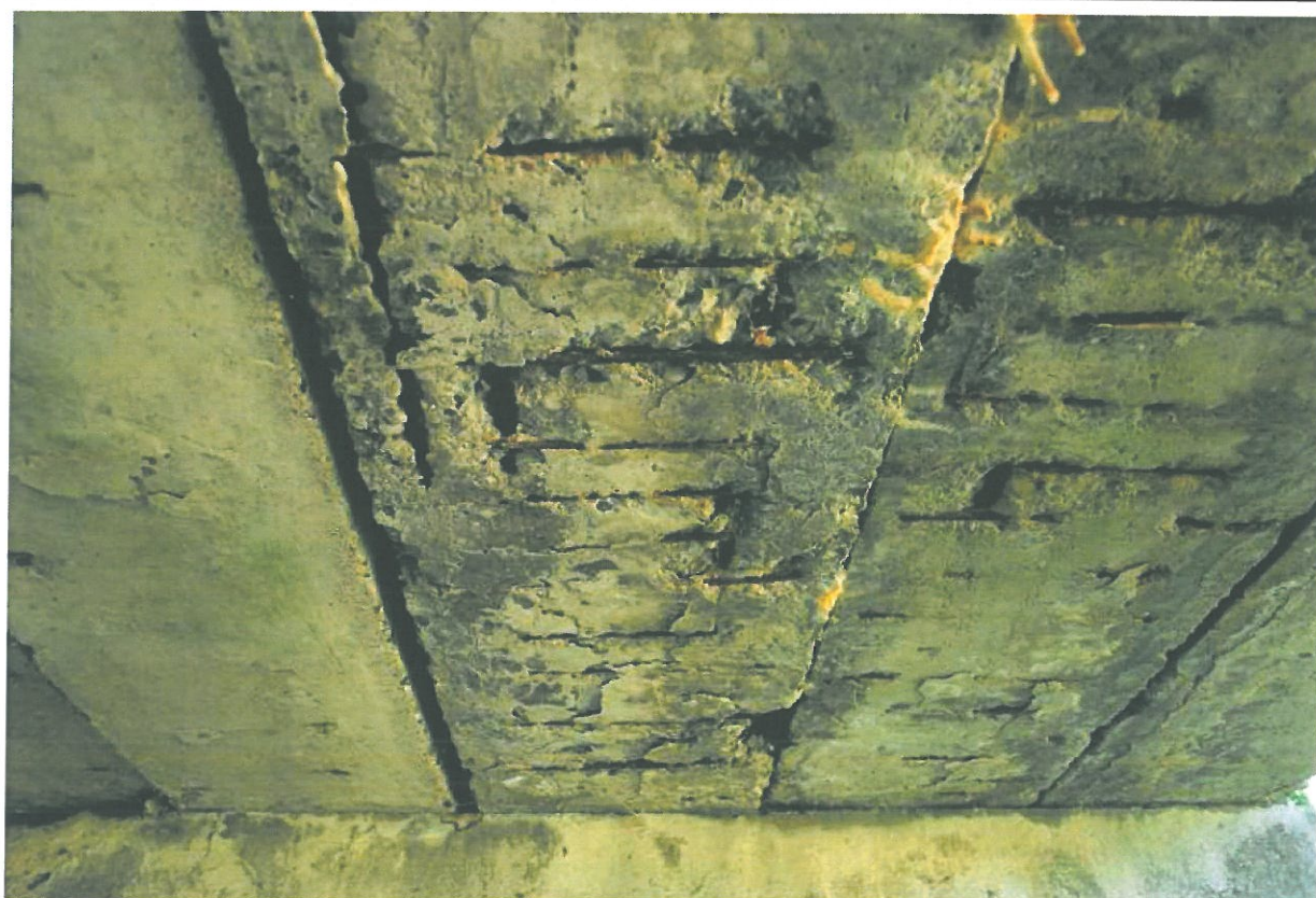
Fot. 18. Widok na belki konstrukcji nośnej obiektu przy przyczółku wschodnim. Widoczne zacieki, korozja stali zbrojeniowej, rysy i ubytki betonu powstały w wyniku nieszczelności izolacji pomostu.
