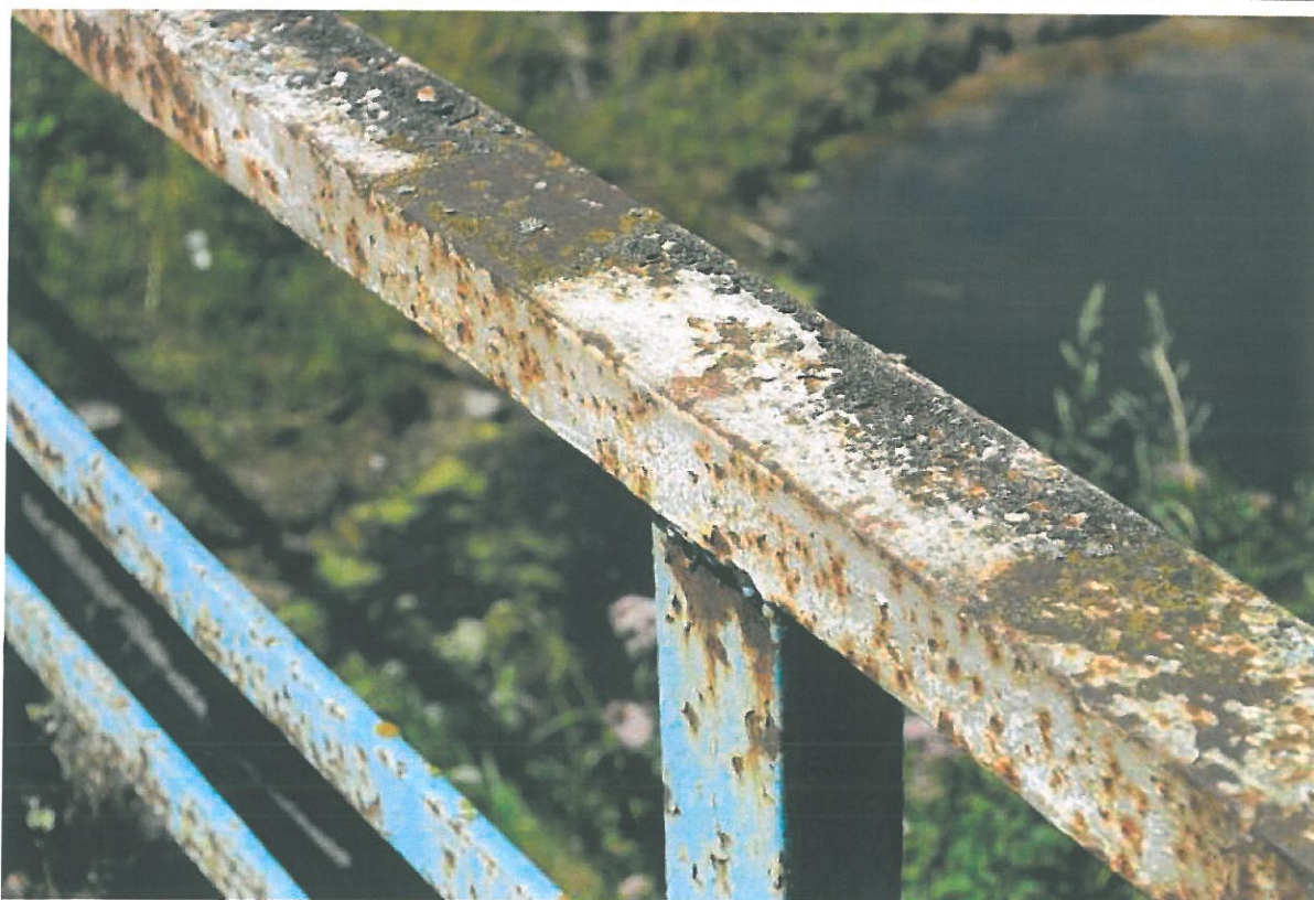
Fot. 10. Widok na pochwyty balustrady północnej. Widoczna korozja stali oraz ubytek zabezpieczenia antykorozyjnego świadczą o braku systematycznych prac utrzymaniowych.
