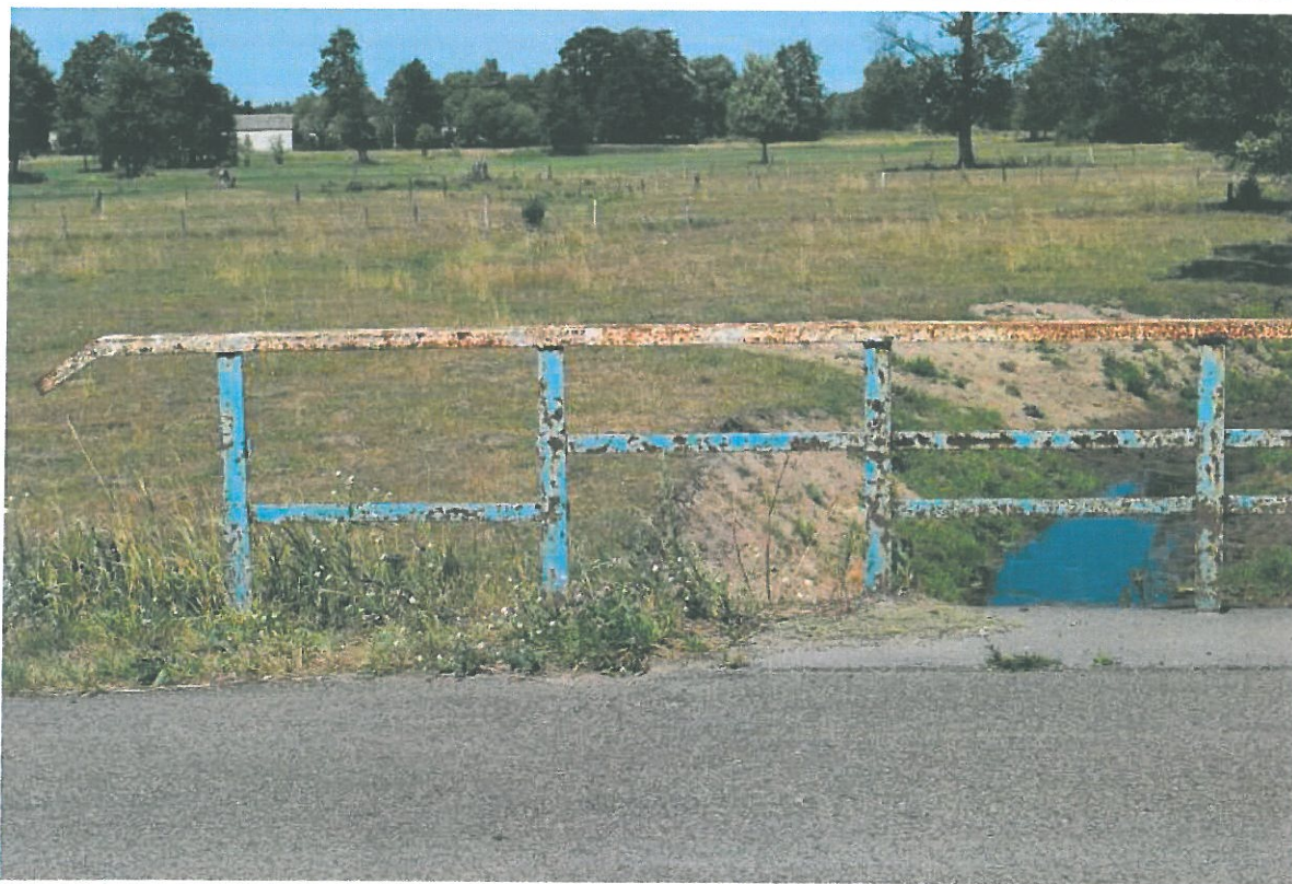
Fot. 11. Widok balustradę północną po stronie przyczółka zachodniego. Widoczna korozja stali oraz ubytek przeciągów balustrady.
