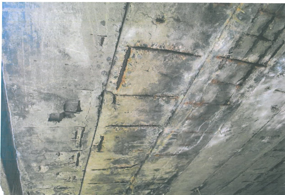
Fot. 15. Widok na belki prefabrykowane po stronie północnej. Widoczne ubytki i rysy betonu, korozja stali zbrojeniowej oraz osady, zacieki i wykwity, które wskazują na całkowity brak skuteczności izolacji.
