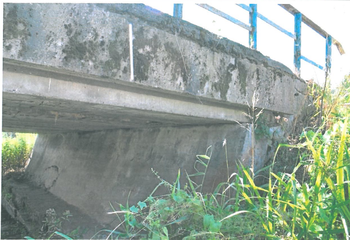
Fot. 13. Widok na gzyms północny przy przyczółku zachodnim. Widoczna wegetacja roślinności oraz zanieczyszczenia betonu.
